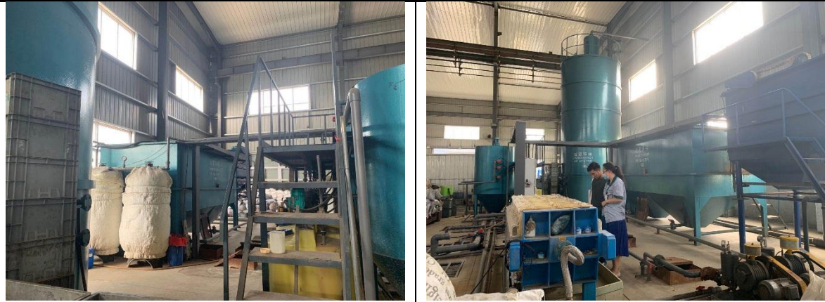
废水处理设施
