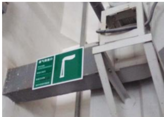
干料预混机除尘器排气筒 P 10
