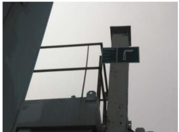
早强剂料仓除尘器排气筒 P 2
