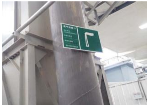
模具清理机除尘器排气筒 P 12
