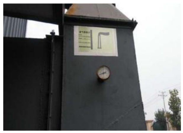
燃气蒸汽锅炉排气筒 P20
