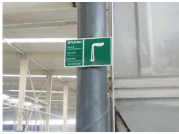
翻转、分片机除尘器排气筒 P16
