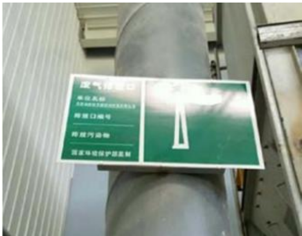
自动拆包机除尘器排气筒 P 1
