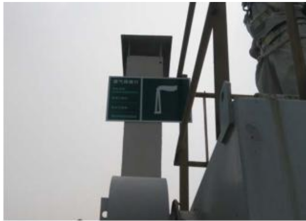
水泥料仓除尘器排气筒 P 9
