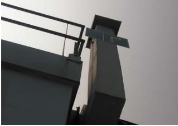
废料料仓除尘器排气筒 P 7
