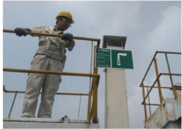
水泥料仓除尘器排气筒 P 8
