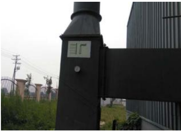
燃气蒸汽锅炉排气筒 P19
