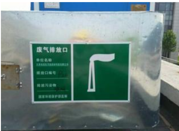
食堂排气筒 P21
