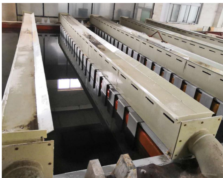
图5-6 低界面条缝式吸风管道的实际案例图
