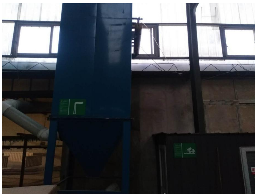
图 4.1-2 布袋除尘器治理设施图
