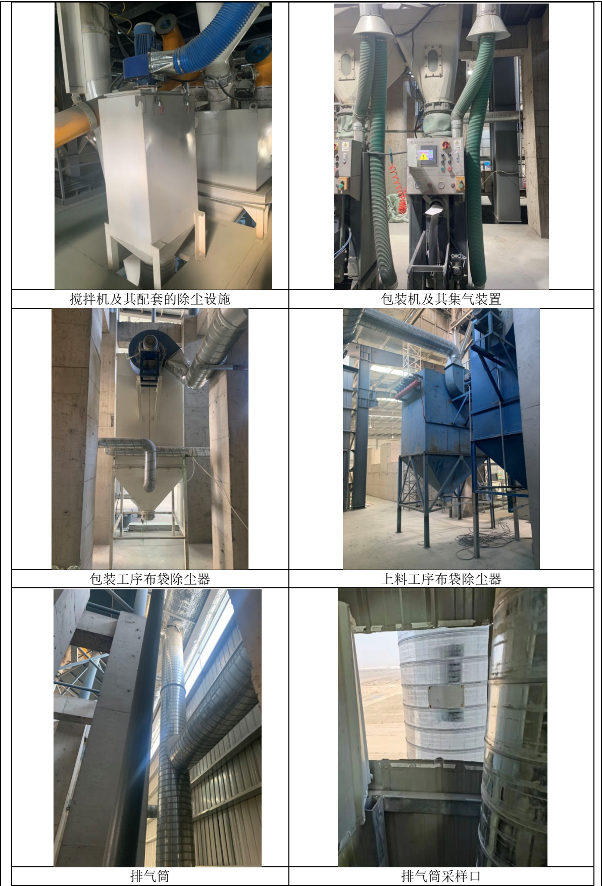
图 5 废气处理装置现场情况图
