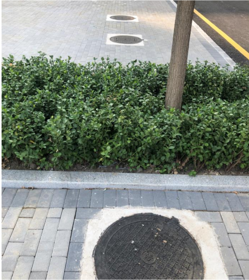
图 3-5 多级化粪池检查井照片
