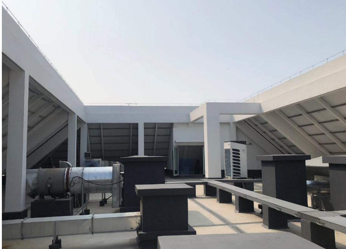
图 3-7 教学楼顶部空调围挡照片
