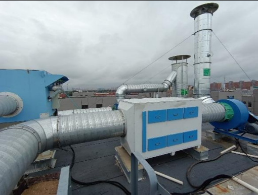
排气筒 P1、排气筒 P2
