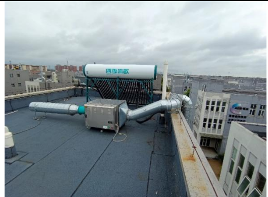
油烟净化器及厨房油烟排气筒
