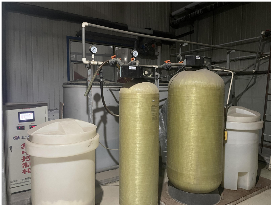
软水制备系统、蒸汽冷凝回收装置
