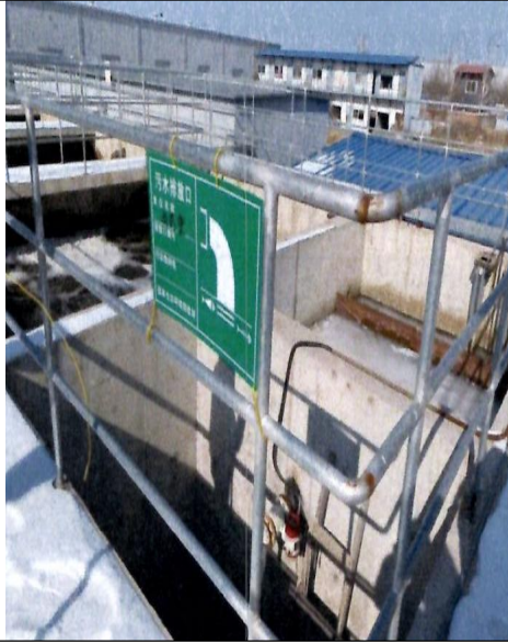
厂区废水总排放口
