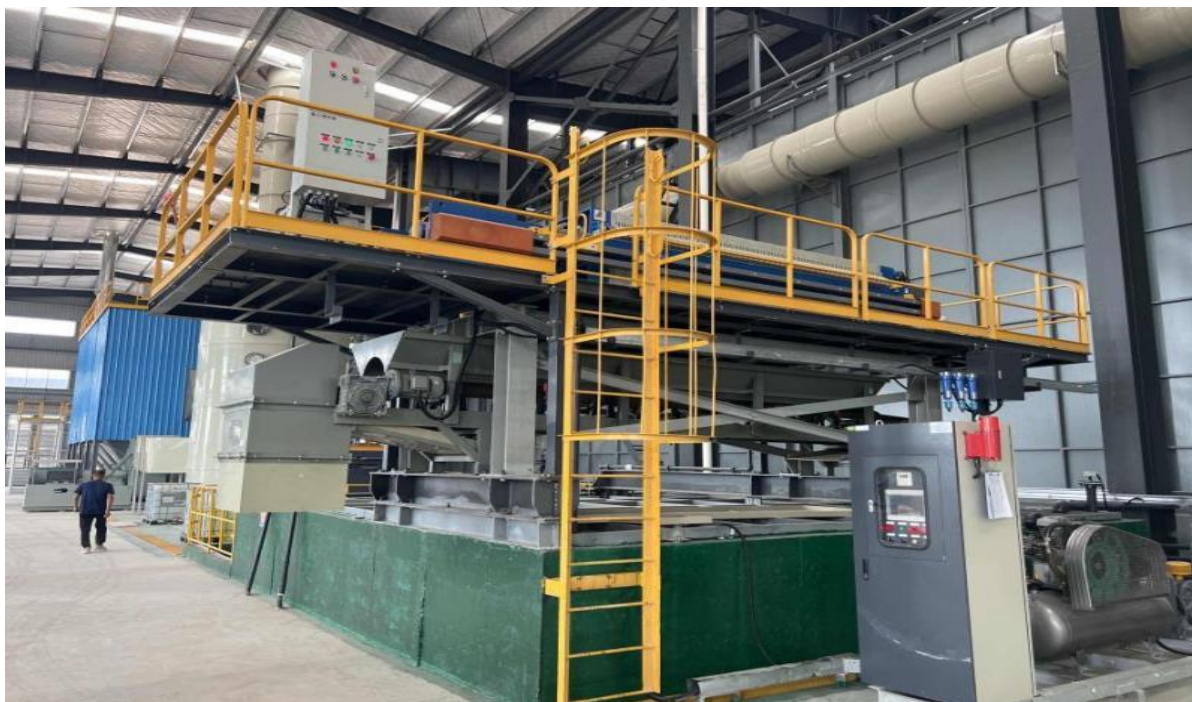
图 4.2-1 污水处理站实物图
