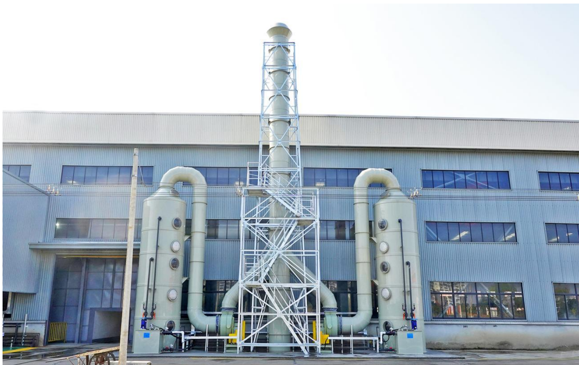
图 5.1-3 前处理封闭间酸雾喷淋塔实物图
