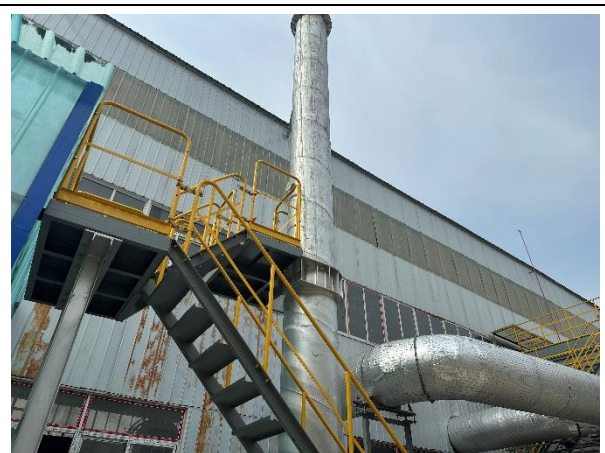
锌锅燃气加热炉排气筒
