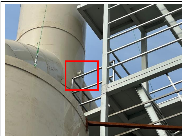
酸雾吸收塔废气检测口
