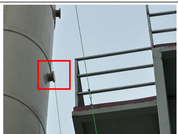
布袋除尘器+水洗喷淋塔废气检测口
