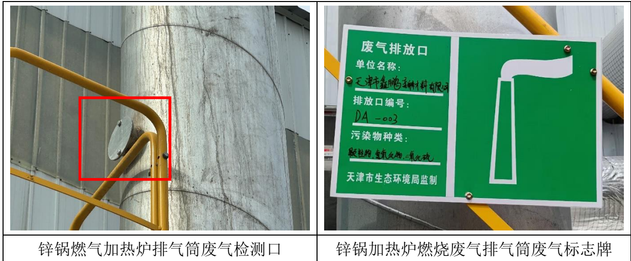
图 4-2 废气治理设施排放口规范化照片
