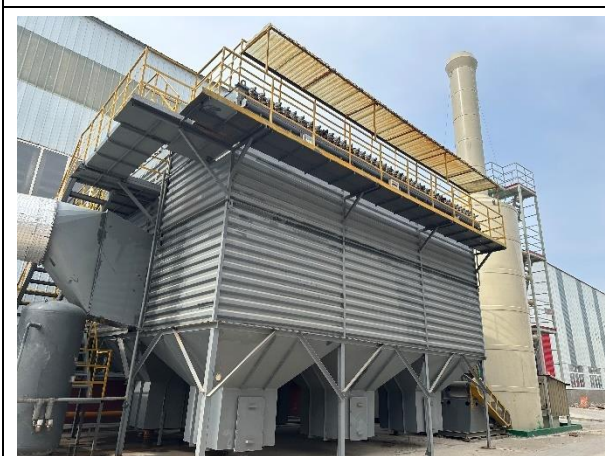
布袋除尘器+水洗喷淋塔
