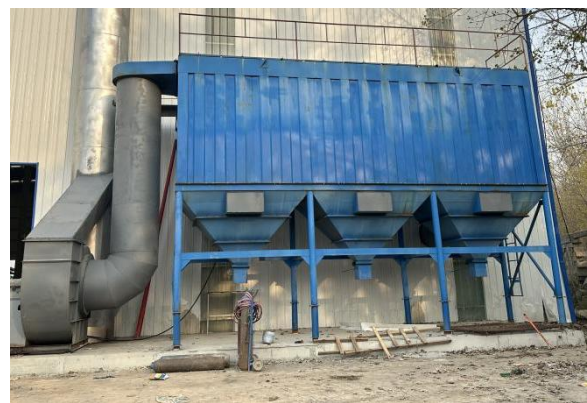
排气筒 P 2 (DA003) 配套布袋除尘器
