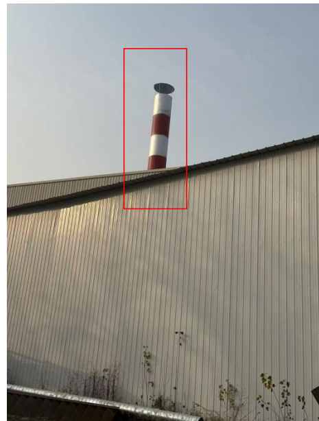
废气排气筒 P 1 (DA001)
